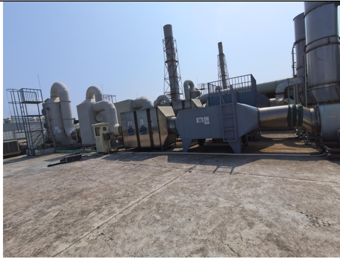
图3.2-4有机废气处理系统照片
